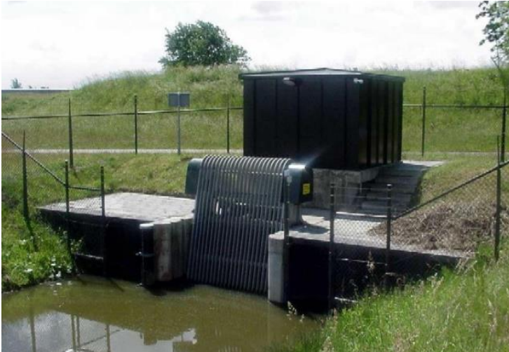
Figuur 7: Gemaal pomp 't Zand
